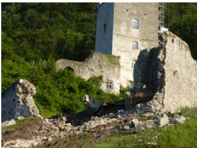
Der durch Hochwasser verursachte Mauerausbruch an der Burganlage Falkenstein.
